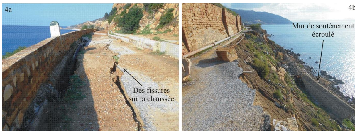
Photos 4 : Désstabilisation de l'ancienne route reliant Sidi Errais à Korbous.
